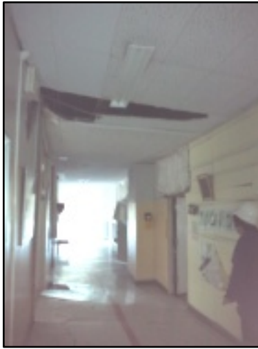
壊れた天井（3月25日撮影）
